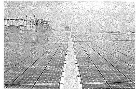
北港物流センターの太陽光パネル
